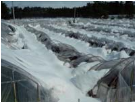
写真45 倒壊したハウスの状況 (外側)
