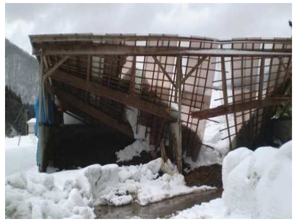
写真 38 堆肥舎屋根の損壊状況
