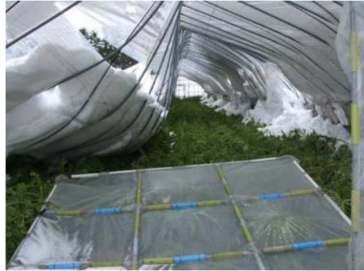
写真46 倒壊したハウスの状況 （内側）
