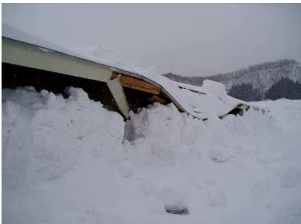
写真 37 畜舎軒先の損壊状況
