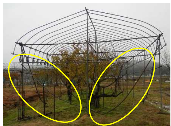
写真 30 沈降力により変形した筋交い パイプ
